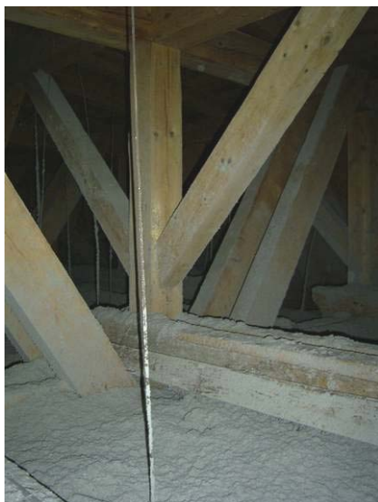
Abb. 7: Verstaubte Hangplätze nach der Wärmedämmung
