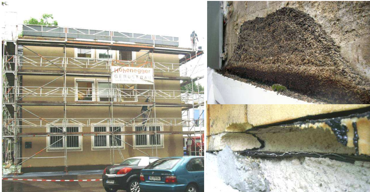
Abb. 11: Sanierung des Abendseglerquartiers in Kempten. Die Tiere siedeln unter der Verblendung der Flachdachkante (li). Im Quartier kommt es zu erheblichen Kotansammlungen (oben re.), da der Kot nicht direkt aus dem Spalt fallen kann. Aushöhlungen in der Schaumstoffisolierung können durch die Krallen der Abendsegler verursacht werden (Bilder: B. Kraft).
